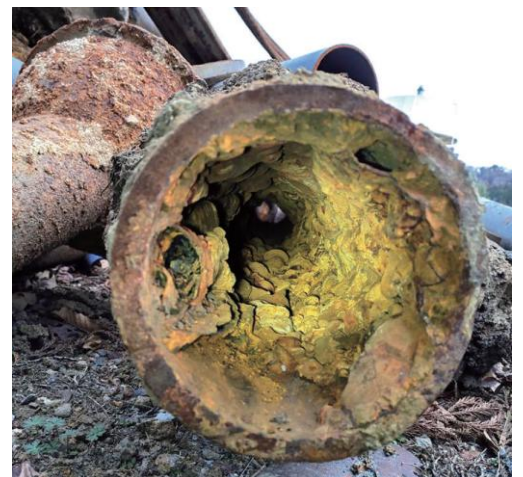
Imagen de tuberías antiguas
