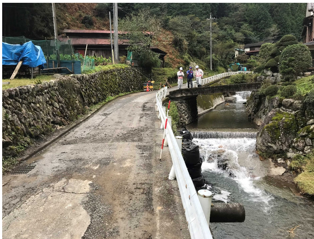
飯能市道5-1-2号線（大字南573-1地先） （道路陥没）
