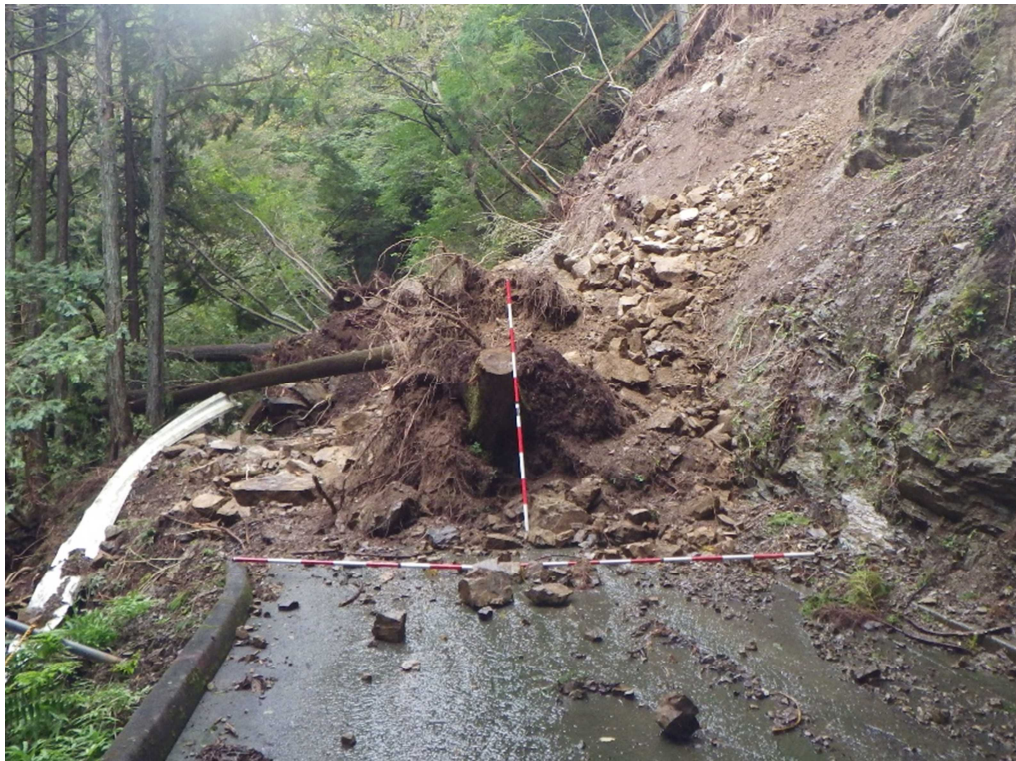
林道横倉線（起点からから600m） （法面崩落）
