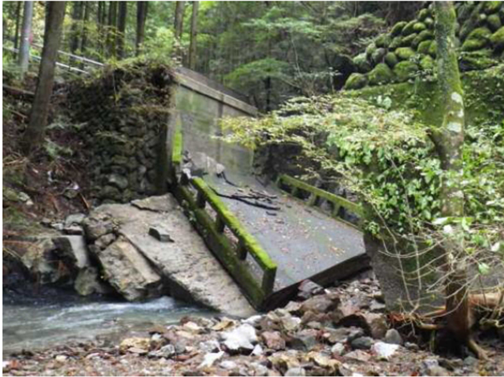
【5号橋】 林道山中線（起点からから1,650m） （落橋）
