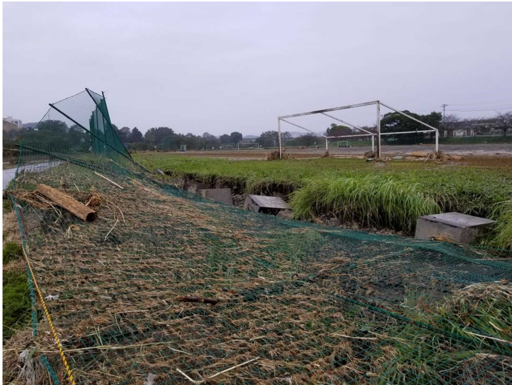
岩沢多目的グラウンド (土砂・流木の堆積、土の流出、フェンス倒壊)
