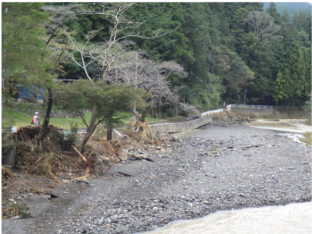
飯能市道6－295号線（飯能市大字井上304－1地先） （護岸洗掘）
