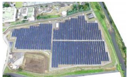
飯能市浄化センター太陽光発電所
