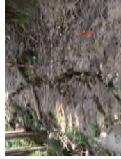
盛土で発生したクラック →
