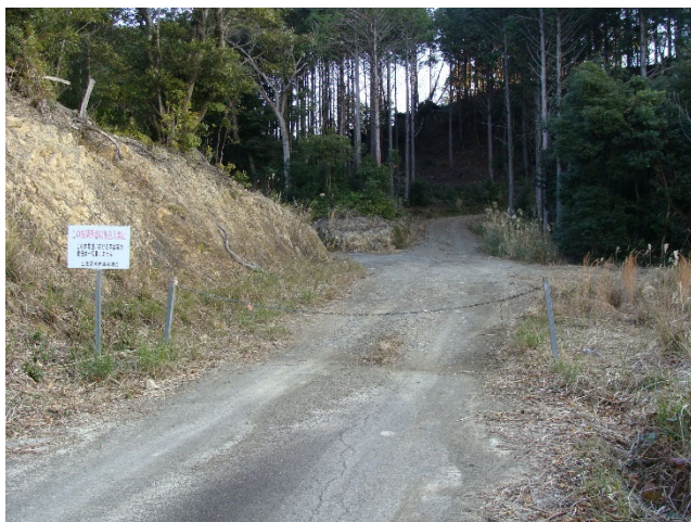
注意喚起看板を設けた一例
