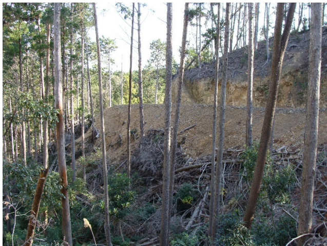
土羽尻からの盛土の流出
