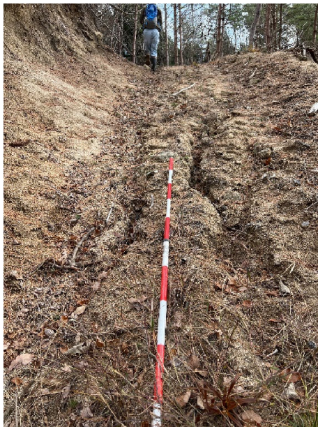
路面洗掘の事例
