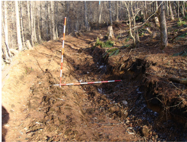
軟弱路盤走行による路盤の痛み
