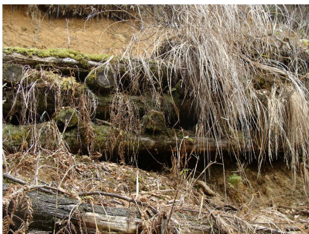
木製構造物の劣化程度の確認
