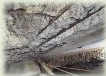
鉄筋露出 コンクリートが剥離し、鉄筋が見えてしまった状態
