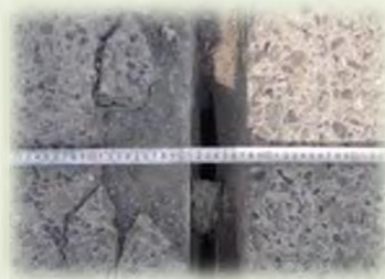
目地材の脱落 舗装面に隙間、段差が生じている状態
