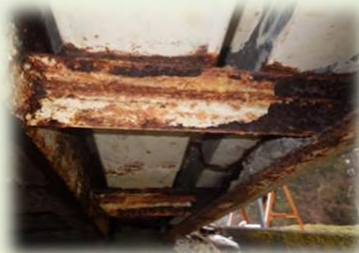
腐食 塗装が腐食している状態
