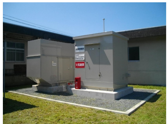
小岩井浄水場自家発電設備
