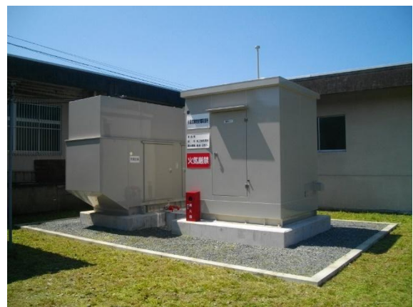
小岩井浄水場自家発電設備
