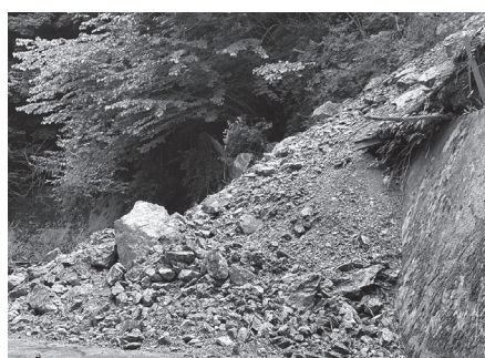
災害復旧にあらず市の財政負担が大きい 「凍結融解による斜面崩落」（本人撮影）
