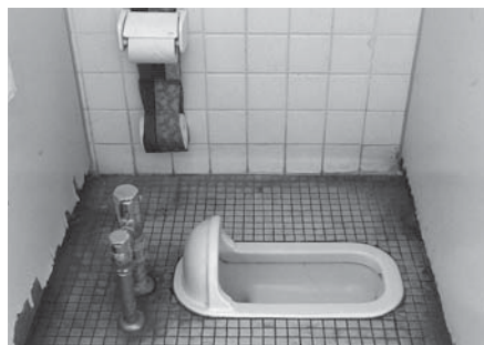
飯能第一小学校内のトイレの修繕を（本人撮影）
