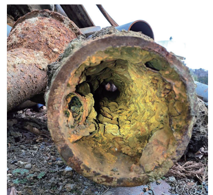
老朽管の様子
