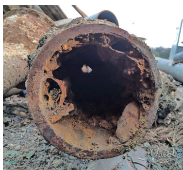
老朽化した水道管
